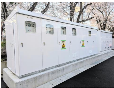
受変電設備（キュービクル）
