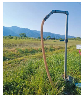
雑用水給水栓(立上り) 必要な時に水を利用できる
