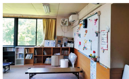
東小学校雨漏りする部屋
