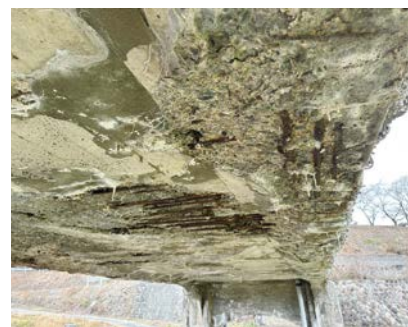
劣化が進みコンクリートが落下し、鉄筋がむき出しになった水路橋下部
