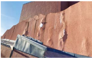
文化センター壁の劣化状況
