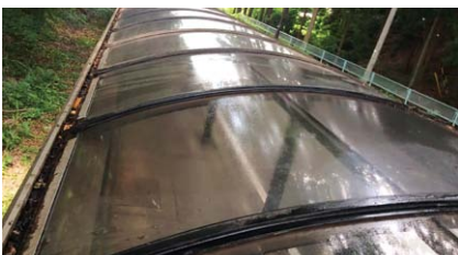
落ち葉を取り除き磨いたパネル
