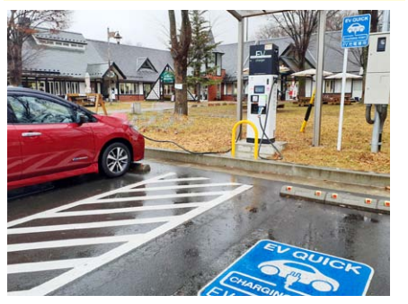
設置が進んだ道の駅「南アルプスむら長谷」の急速充電スタンド。2台同時充電が可能
