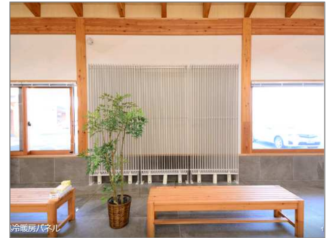
除湿型放射冷暖房設備(朝日村庁舎)
