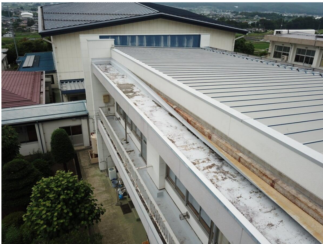
② 管理棟屋根破損状況（東南から）
