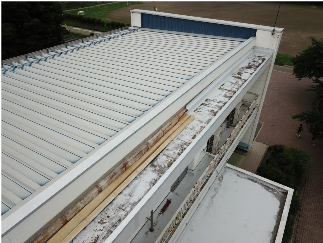
① 管理棟屋根破損状況（西南から）
