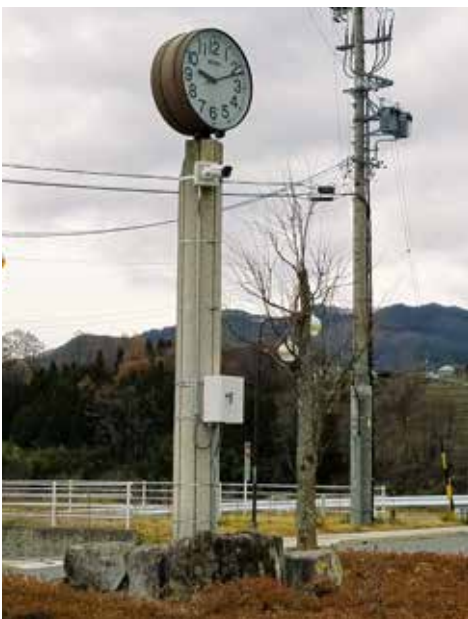
▲ 新設された天竜公園の防犯カメラ
