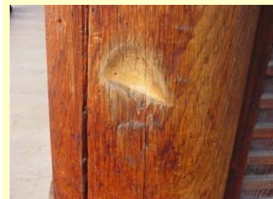
現在も善光寺に残る地震の痕 落下した鐘がつけた傷とされる
