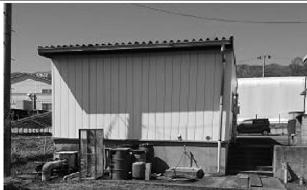
224 一の宮汚泥処理施設 受入スクリーン室設備棟 外壁劣化状況
