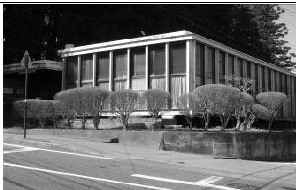
229 健康福祉センター 南東面劣化状況
