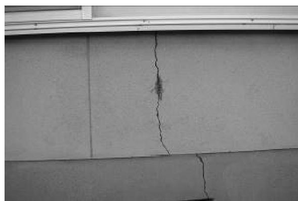
135 木下団地東集会所 基礎・外壁亀裂状況
