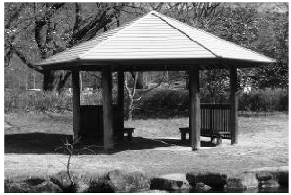
218 みのわ天竜公園 四阿 柱腐食
