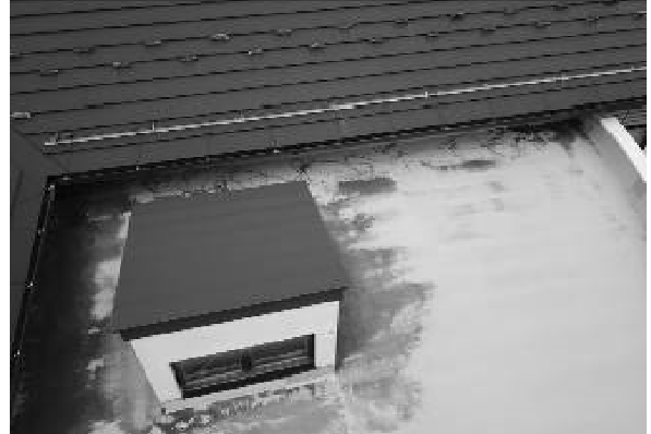
139 大出コミュニティセンター 屋根シート防水劣化状況
