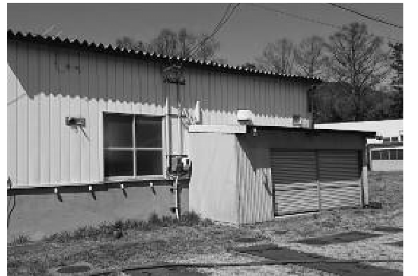
225 一の宮汚泥処理施設 汚泥コンポスト室設備棟 劣化状況
