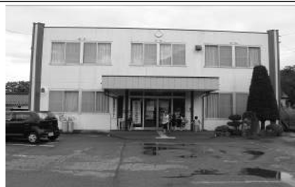
134 上古田転作促進研修センター 北面塗装剥離状況
