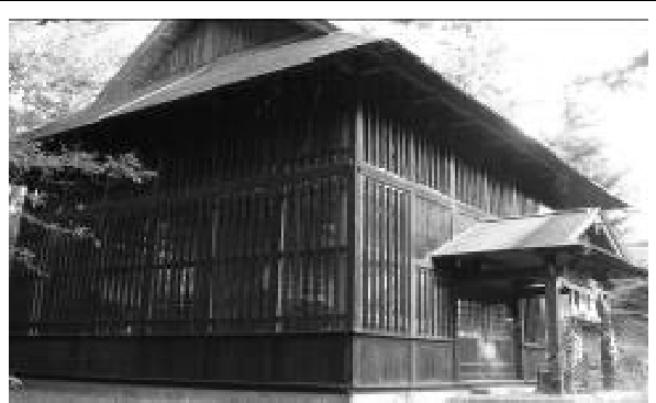
158 ふるさと文化保存館 北西面木材変色状況
