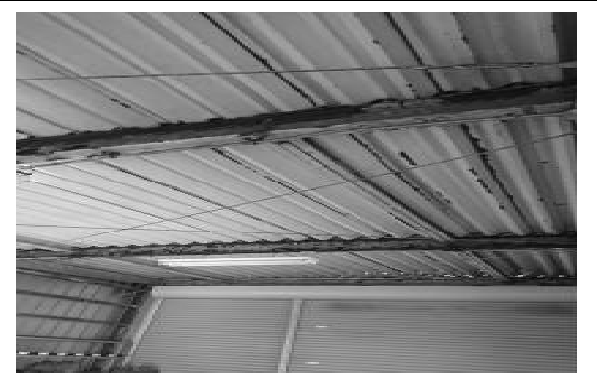
224 一の宮汚泥処理施設 受入スクリーン室設備棟 内部鉄骨腐食状況
