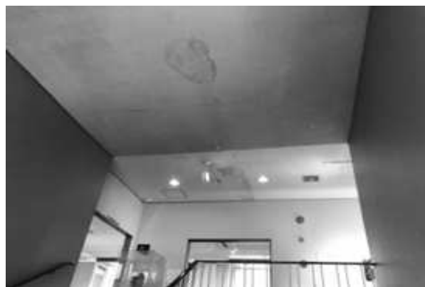
階段室天井雨漏り跡
