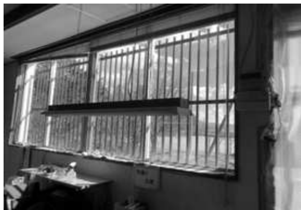
1階事務室内 南側天井から窓枠周り雨漏り
