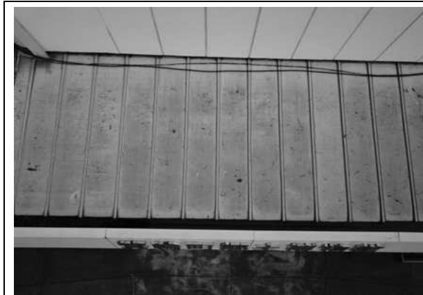
屋根の状況（拡大）
