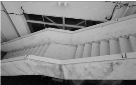
教室棟外壁・外階段劣化状況
