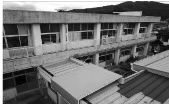
南校舎（教室棟）外壁劣化状況
