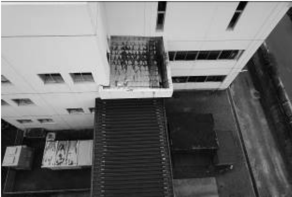
渡り廊下屋根錆発生状況
