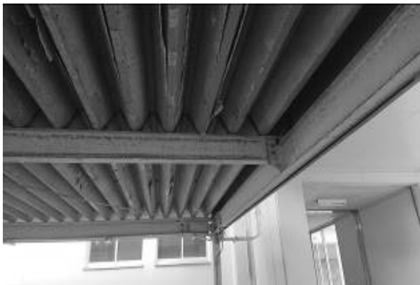
渡り廊下屋根折版断熱材剥離
