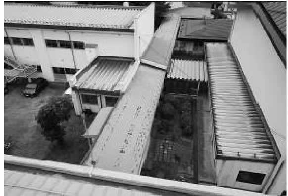
渡り廊下、中校舎屋根錆状況
