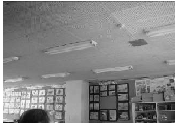
教室棟塗装薄利・変色状況
