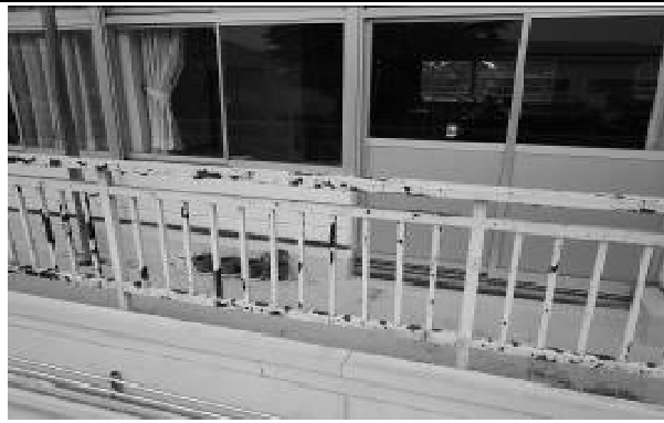
バルコニー手摺錆発生状況
