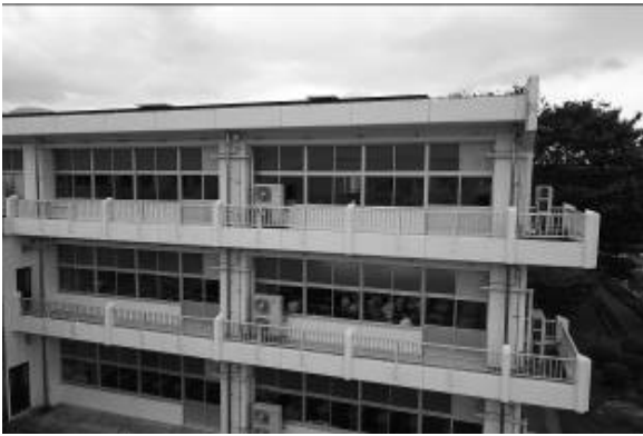
教室棟塗装剥離・変色状況
