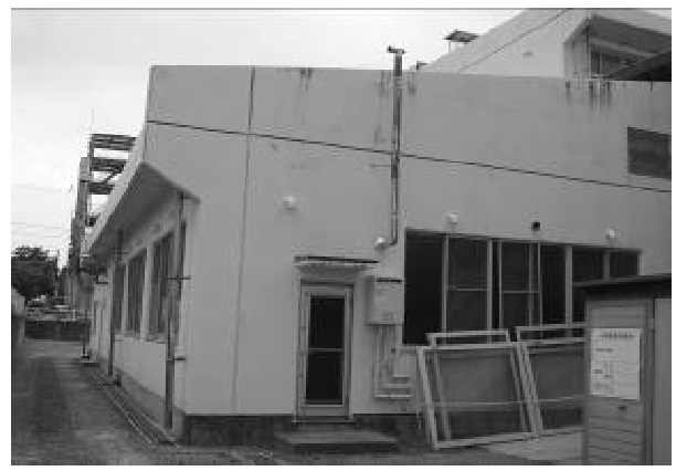
旧給食室外壁剥離状況
