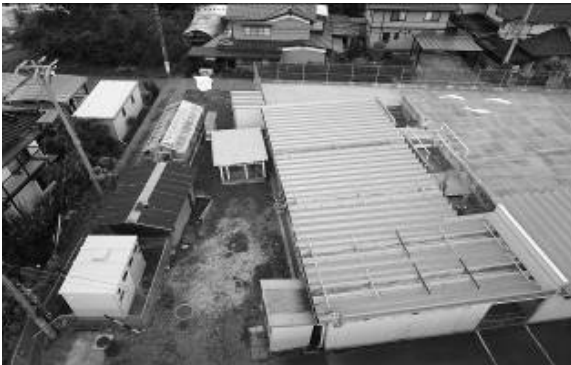
プール付属棟屋根錆発生状況
