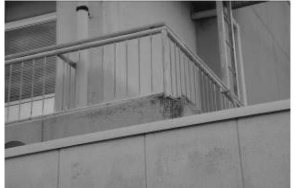
管理棟外壁剥落状況
