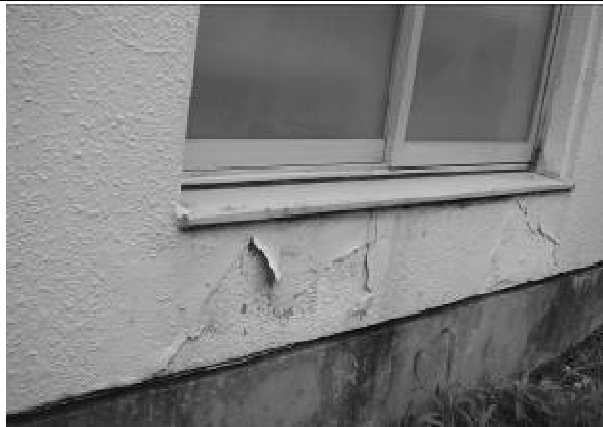
第2棟外壁塗装剥離状況
