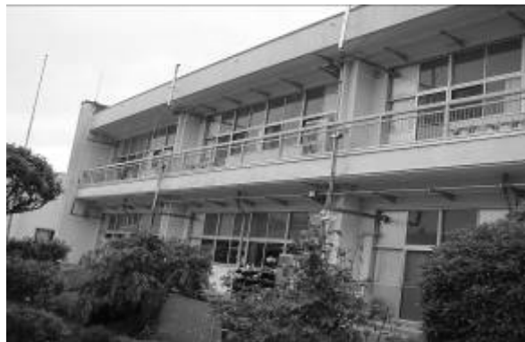
管理教室棟外壁塗装剥離状況
