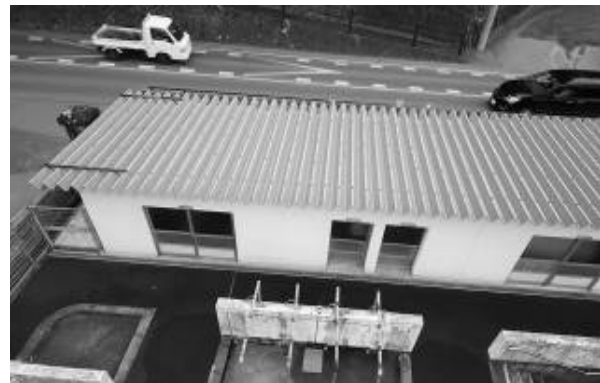
プール付属棟屋根錆発生状況
