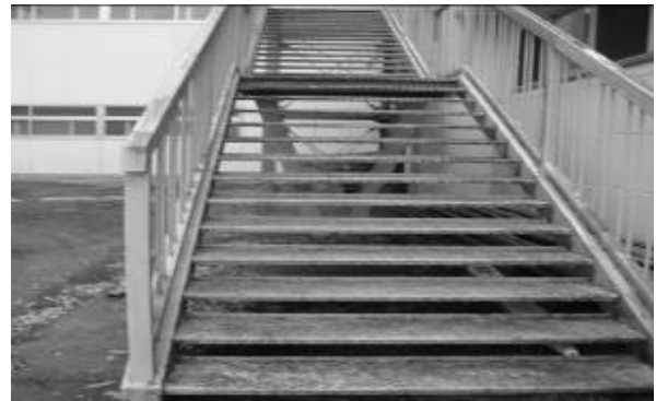
外階段錆発生状況
