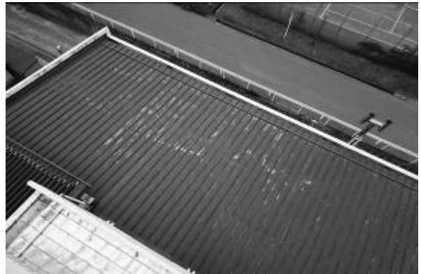
旧給食室屋根錆発生
