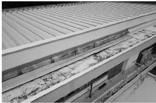
中校舎防水破損状況
