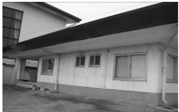
給食室外壁塗料剥離状況
