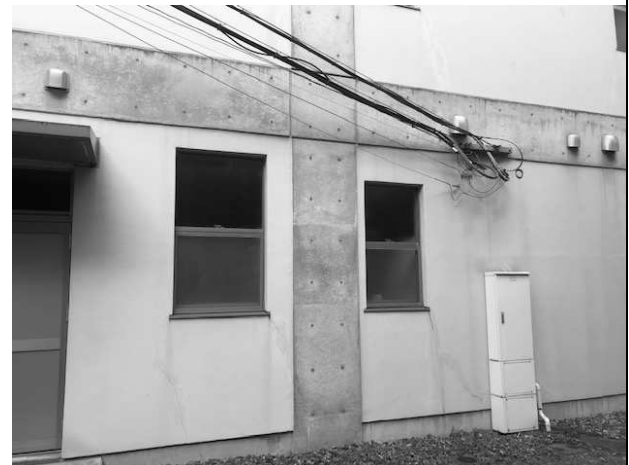
外部状況（クラック状況）
