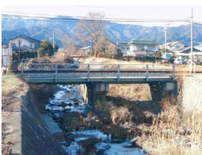
増水時の排水能力が懸念される 帯無踏切付近
