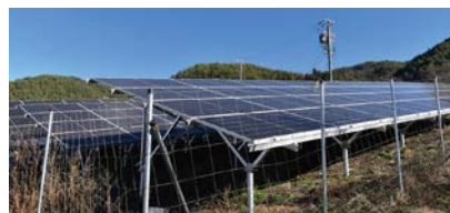
斜面に設置された太陽光パネル
