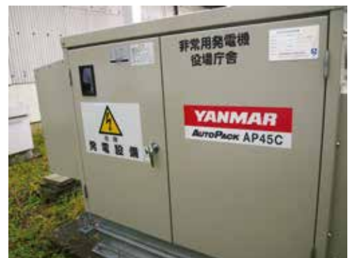
▲ 新規に設置された発電機
