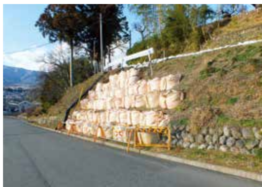
▲ 福与鹿垣の崩落箇所
