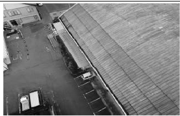
屋根の錆発生状況
