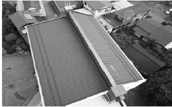
屋根の錆発生状況
