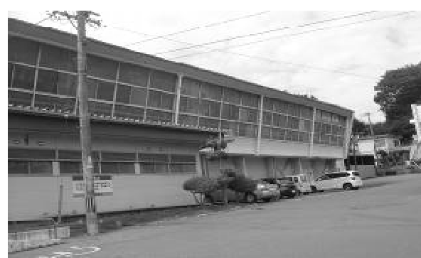
外壁 ALCクラック
