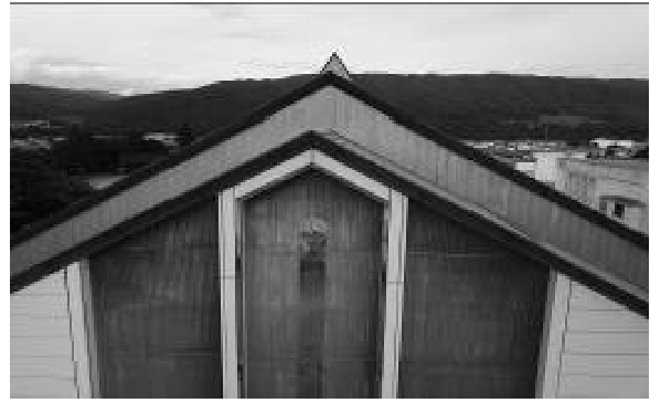
西面外壁変色状況
