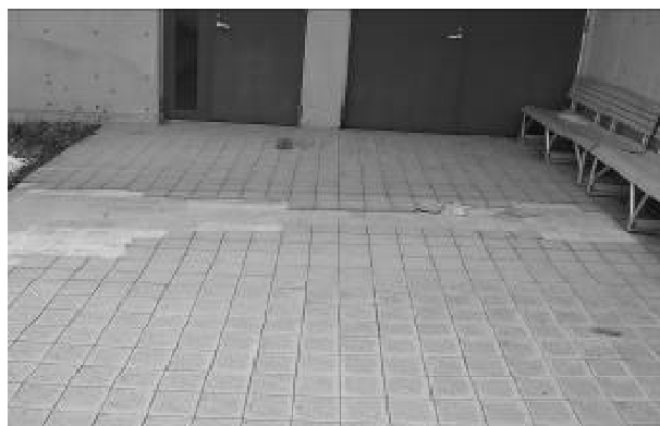
床タイルの剥離状況
