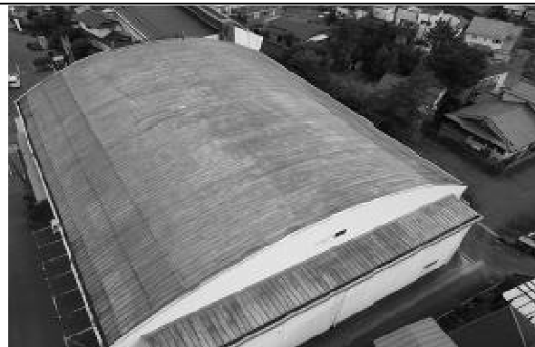
屋根の錆発生状況
