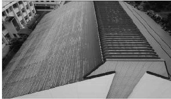
屋根塗装の剥離状況
