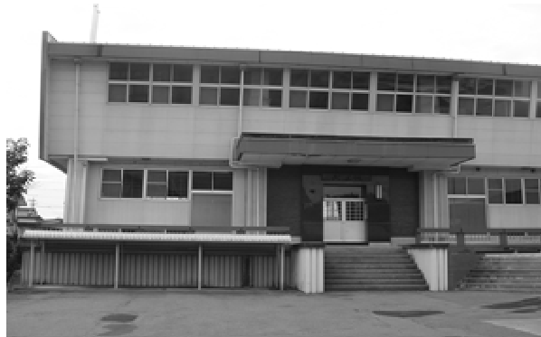
外壁 A L C 塗装剥離状況
