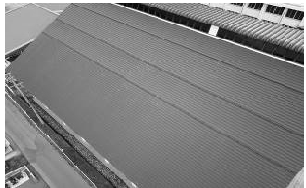
屋根塗装の剥離状況
