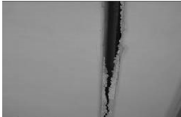
目地シーリング亀裂の状況
