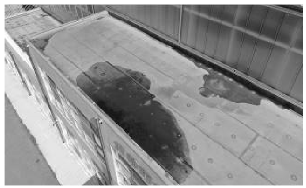
玄関底シート防水劣化状況
