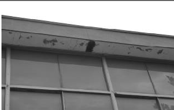
軒天塗装剥離状況
