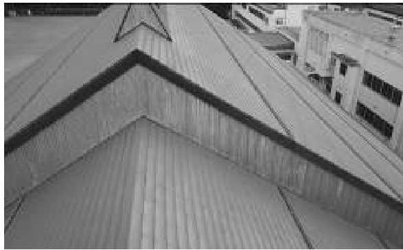
屋根の劣化状況
