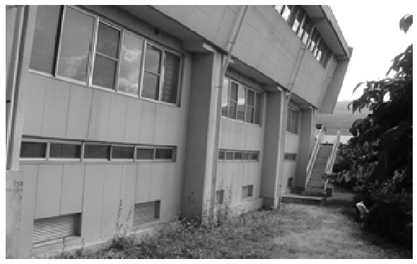
外壁 A L C 塗装剥離状況
