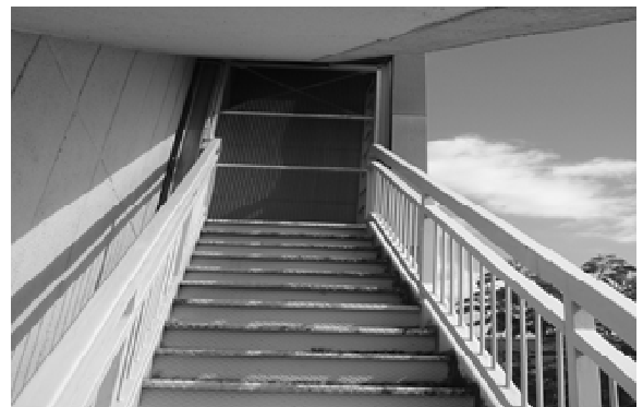
外階段錆発生状況
