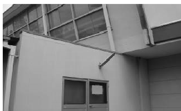
外壁 ALCクラック
