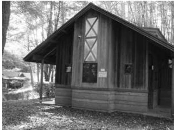
193 トイレ(キャビン西) 屋根にカビ・錆発生
