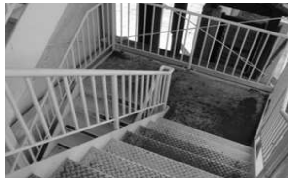
西棟 屋外鉄骨階段 錆の発生状況
