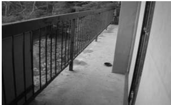
宿泊棟 錆の発生状況
