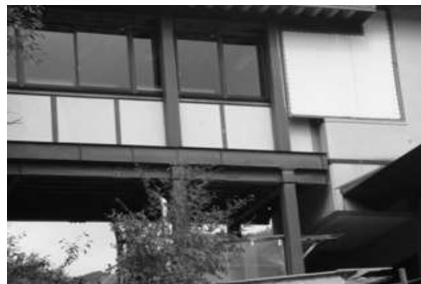
連絡ブリッジ 鉄骨柱に錆が発生している
