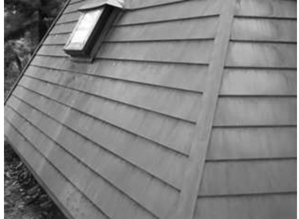
197 キャビン 屋根に変色・カビ・部分的に錆発生
