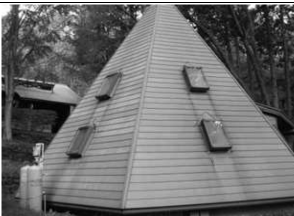
190 キャビン 屋根に錆及びカビが発生
