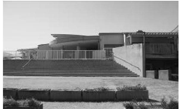
東面外壁塗装の剥離状況
