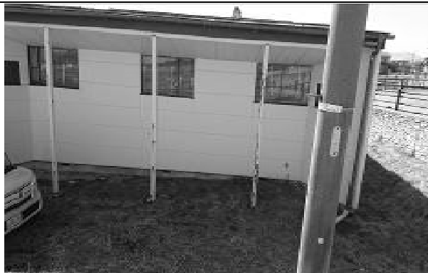
北面鉄骨錆発生状況
