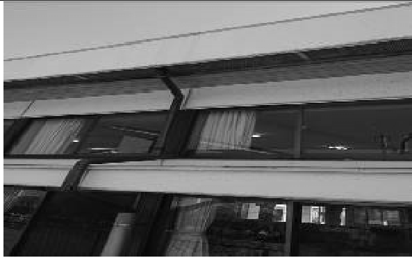
外部の軒天のたるみ等の状況
