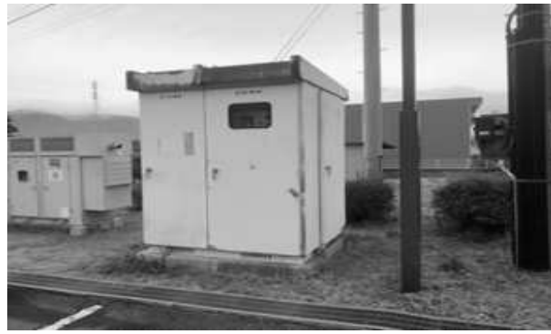
更新時期を迎えている高圧受変電設備
