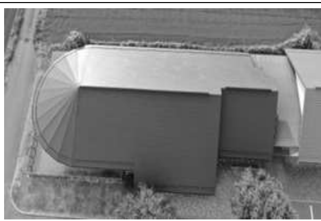
162 にこりこキッチンたべりこの屋根の状況
